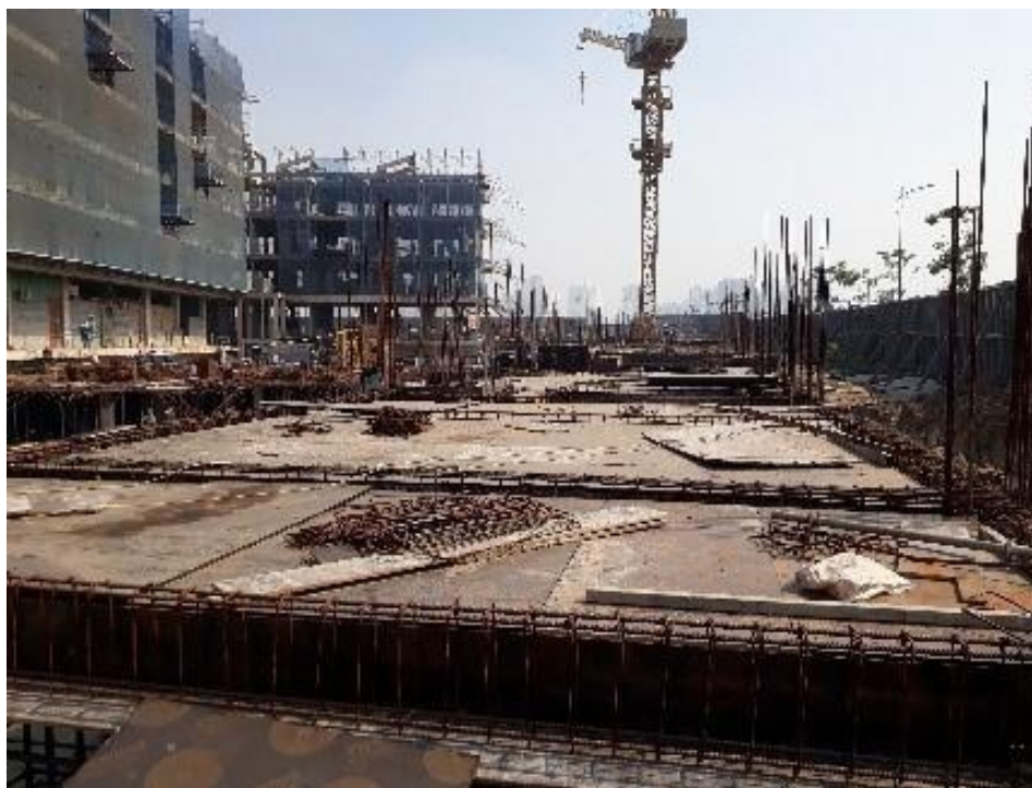
Lakeview 2: Khu 3 và 4 đang thi công lắp dựng cốt sàn tầng hầm
